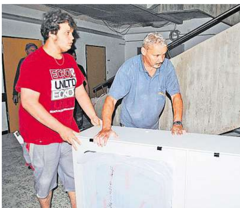
Der Elektrohauptverteiler kommt in das Untergeschoss.
